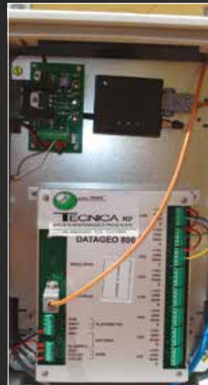
MONITORAGGIO STRUTTURALE IN AUTOMATICO
